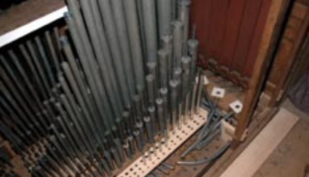
Sur cette photo prise en cours de remontage, on remarque le faux-sommier neuf de la Fourniture 3 rgs et quelques tuyaux neufs en copie de Silbermann.
